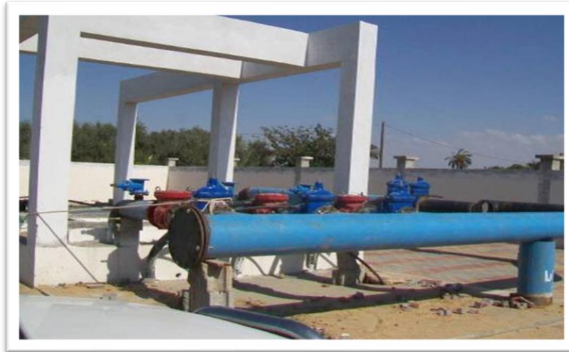
Fig (17) Al Berka WW pump station- Dair Al Balah
